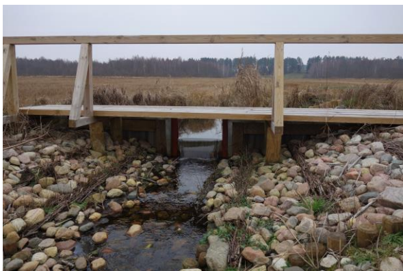
Rys. 4. Zastawka z piętrzeniem na rowie RM/1 w obiekcie melioracyjnym „Kamienna – Kropiwno” obszar Kamienna Nowa
