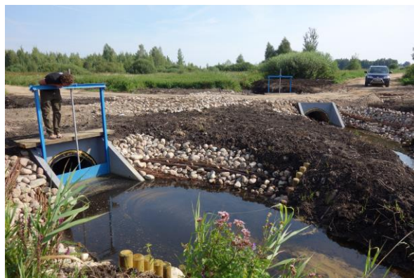
Rys. 5. Przepusty piętrzące na rowie na rowie R-A w obiekcie melioracyjnym „Kamienna – Kropiwno” obszar Szuszałewo
